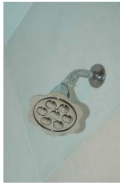
Bild 2: Die Duschbrause ragt aus der Wand
